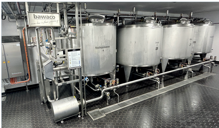
CIP-Anlage (Bildnachweis: bawaco gmbh)
